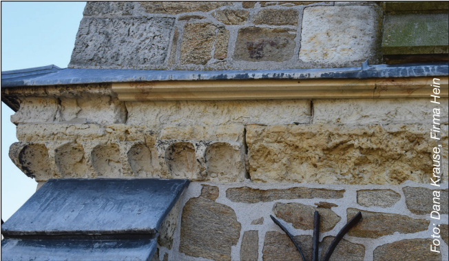
Schadhafter Sims an der Ostfassade
