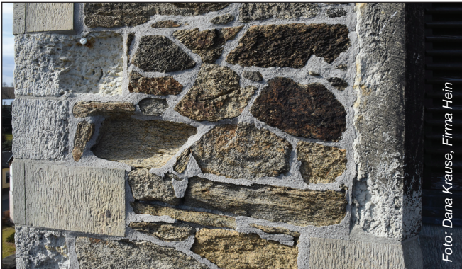
Löcher in der Nordfassade durch fehlende Gneisteile
